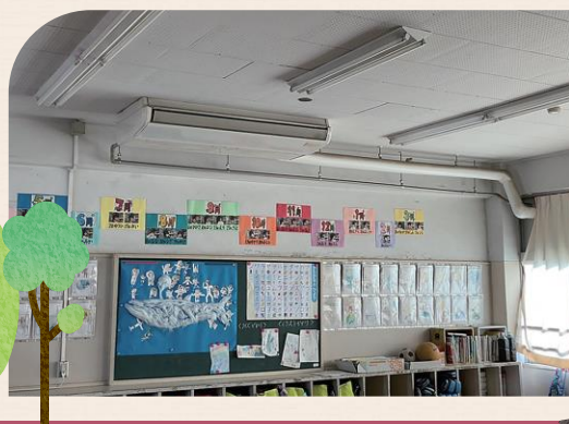
教室に設置されたエアコン
