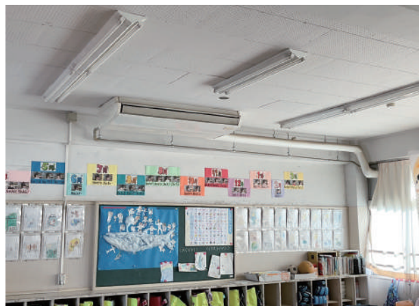
教室に設置されたエアコン
