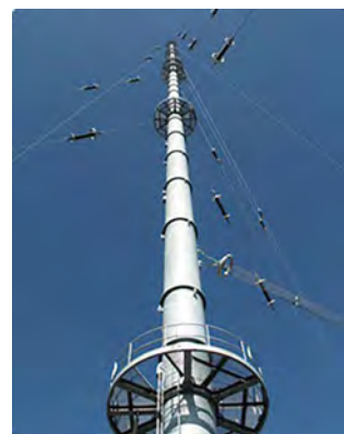
長波支線式送信鉄塔 国内でも特殊な長波支線式鉄塔アンテナの設計・製作・建設工事を行い、メンテナンスまで一貫して手がけています
