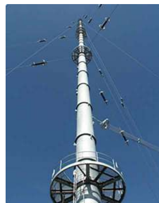
長波支線式送信鉄塔 国内でも特殊な長波支線式鉄塔アンテナの設計・製作・建設工事を行い、メンテナンスまで一貫して手がけています
