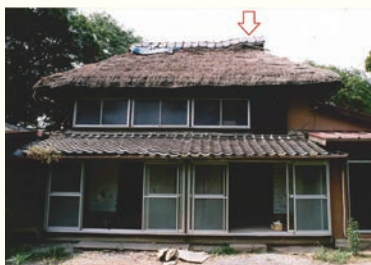
▲大震災の影響でゆがんだ早船屋の棟瓦
