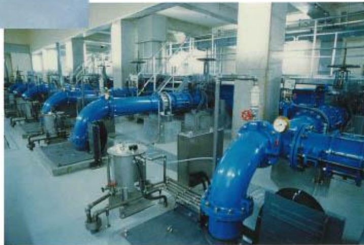
配水ポンプ設備
