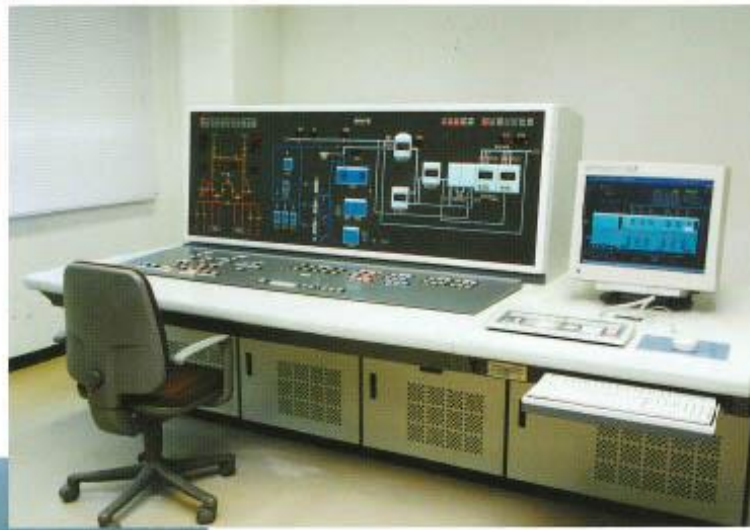
監視制御設備
