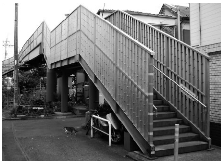
改善が望まれる藤間北野歩道橋
