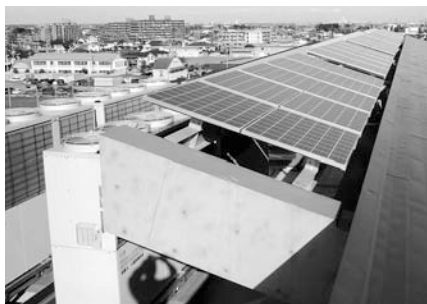
東台小学校の太陽光発電パネル
