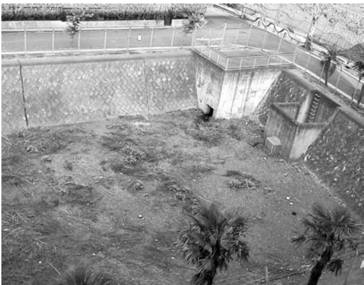
衛生面の管理が望まれる雨水調整池
