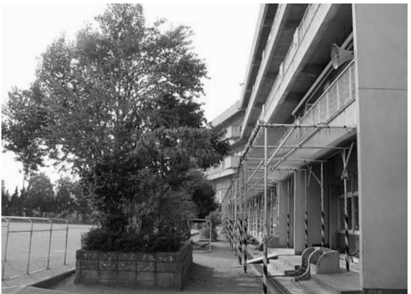
元福小の外壁落下防護ネット
