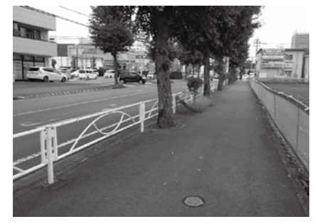
歩道部分に埋設されている石綿セメント管
