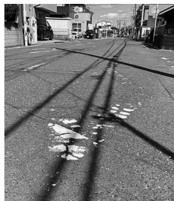
消えかかった路面表示
