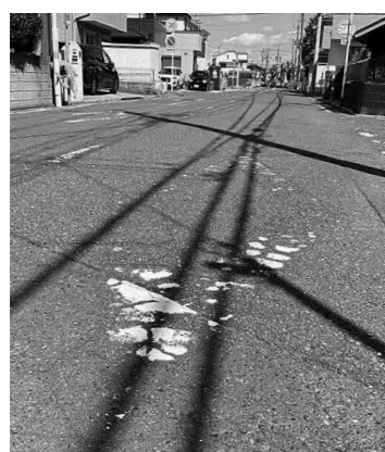
消えかかった路面表示
