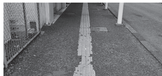
点字ブロックの修繕が急がれる
