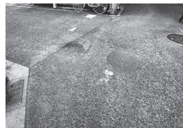
傷んだ舗装の修繕を
