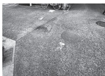
傷んだ舗装の修繕を
